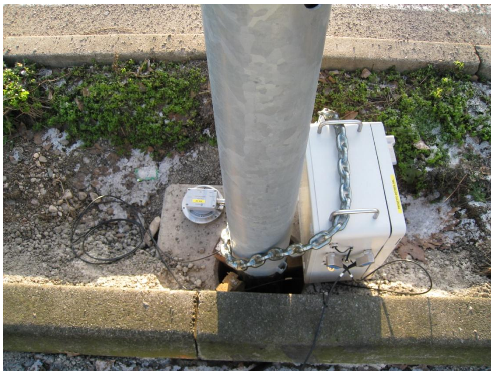
Figura 40: Esempio centralina di monitoraggio
