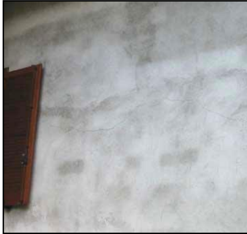
Figura 22: Esempio di abitazione con evidenziati alcuni danni di soglia
